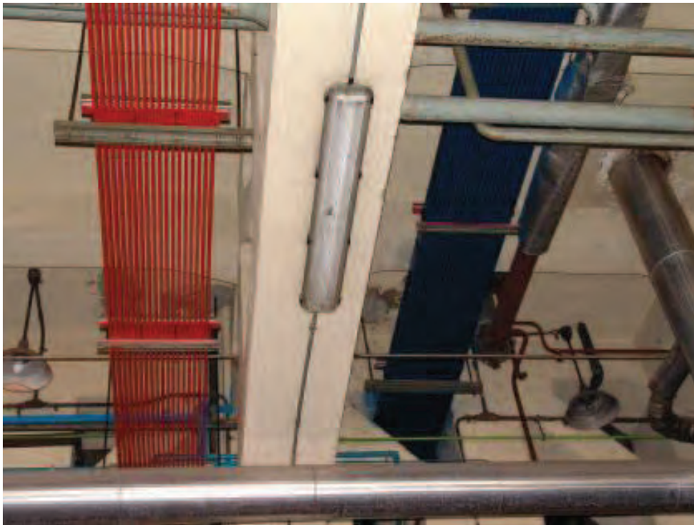
Fig. 41 – Sbarratura in rame
