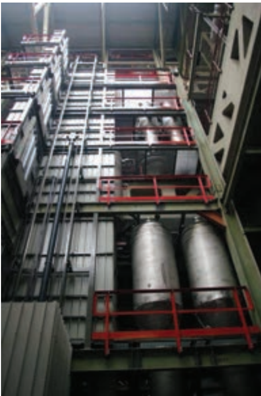
Figura 5 – Impianto SPES-3 nello stato attuale di avanzamento
