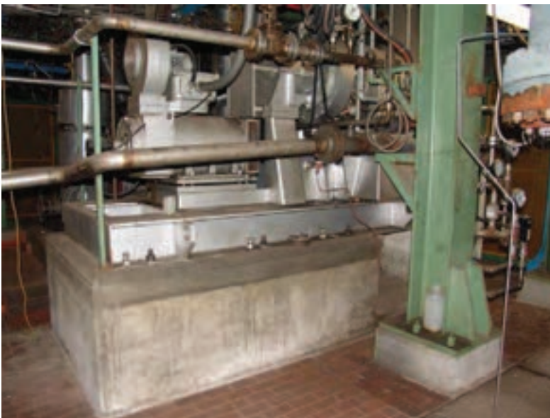
Figura 14 – Pompa di ricircolo
