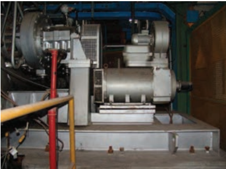
Figura 13 – Pompa di ricircolo
