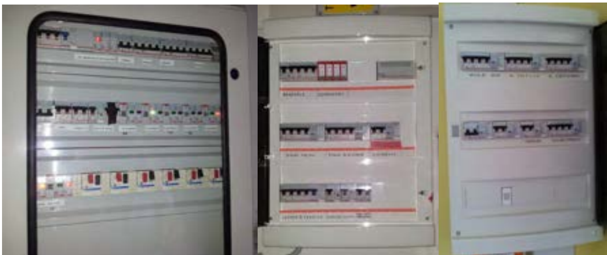
Figura 6. Quadro elettrico centrale termica, del piano terra e del primo piano
