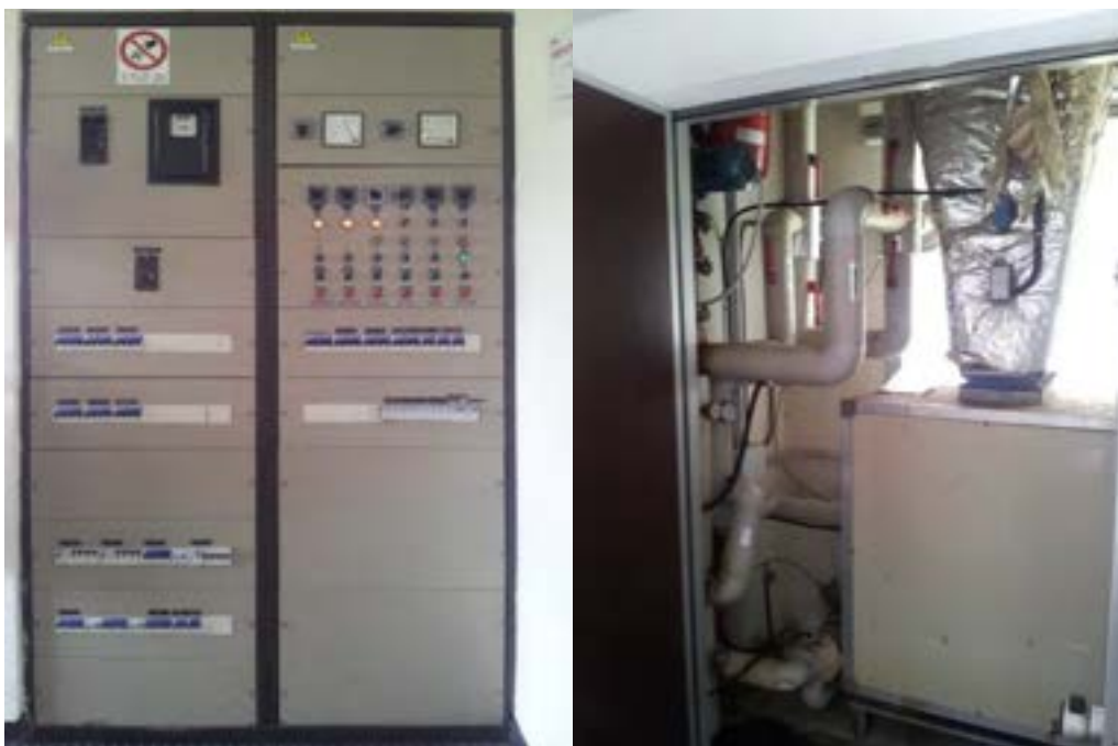
Figura 15: Quadro elettrico e sottocentrale termica dell'edificio.
