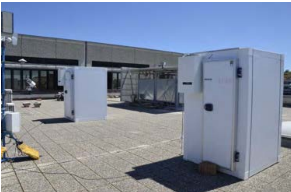
Figura 1. Le celle frigorifere identiche installate sulla superficie all'aperto del Laboratorio di Energetica Ambientale
