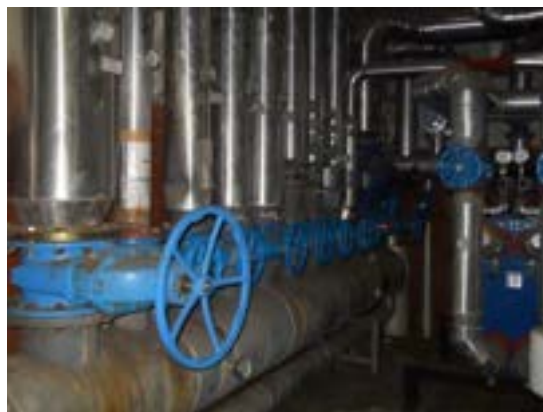
Figura 10 - Collettore di mandata dell'impianto
