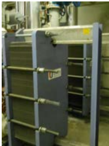
Figura 15 - Scambiatori di calore lato circuito di teleriscaldamento
