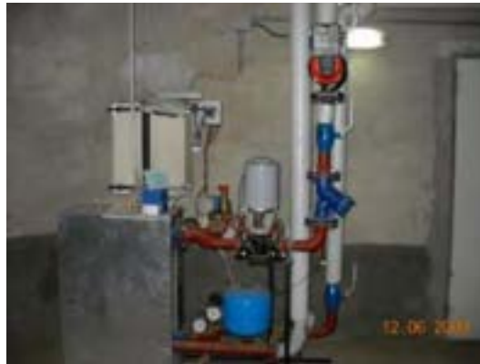
Figura 27 - Piè di stabile con sottostazione di scambio
