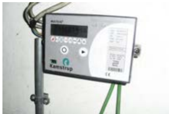
Figura 17 - Misuratore di calore nr.9
