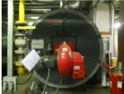
Figura 7 - Caldaie Vitomax 200 tipo M241
