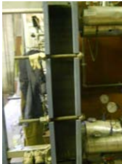
Figura 11 - Scambiatore di calore lato circuito palazzina uffici
