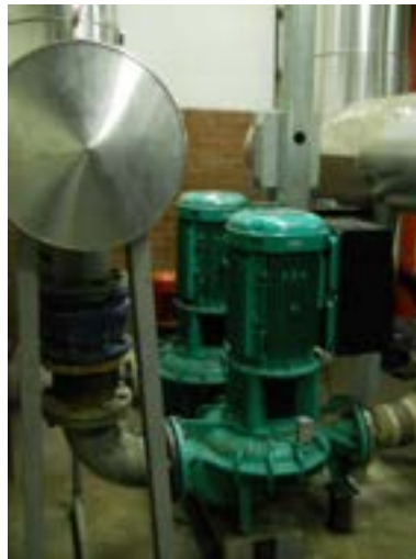
Figura 16 - Pompe del circuito di teleriscaldamento
