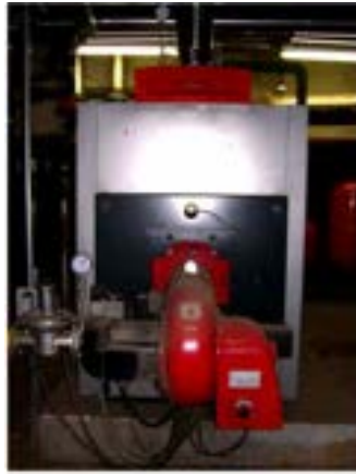
Figura 6 - Caldaia Viessmann Vitocrossal 300 tipo CR3
