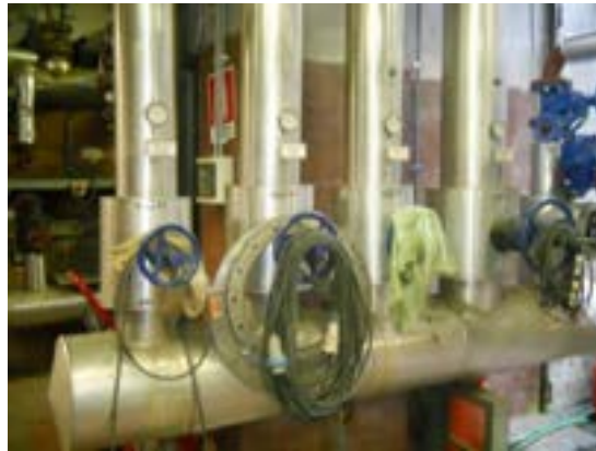
Figura 14 - Collettore circuito palazzina uffici
