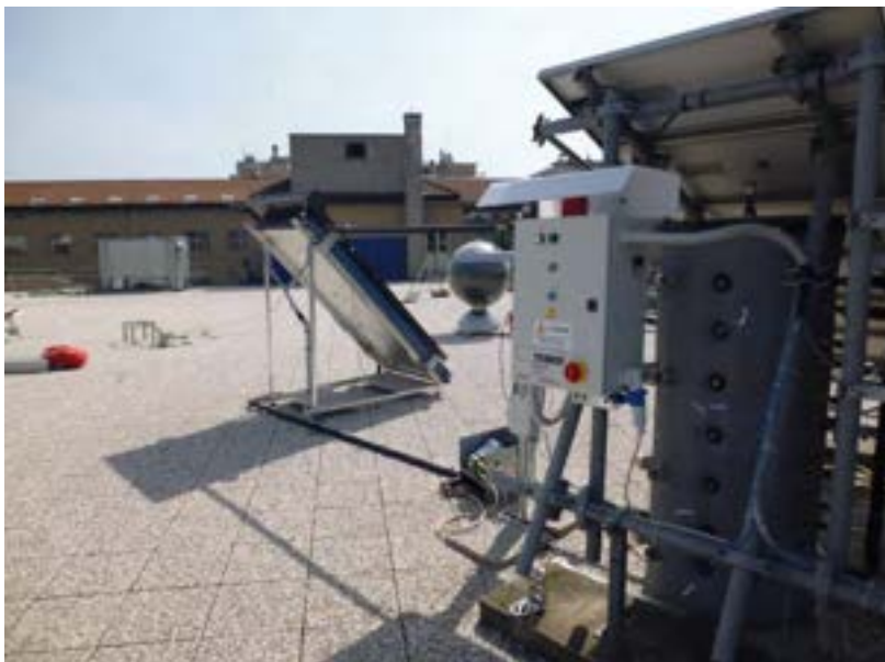
Figura 12. Il dimostratore in scala reale montato sul tetto del Politecnico di Torino
