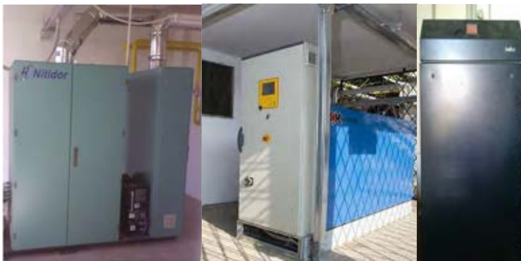
Figura 41. Micro-cogeneratore ( \mu CHP)
