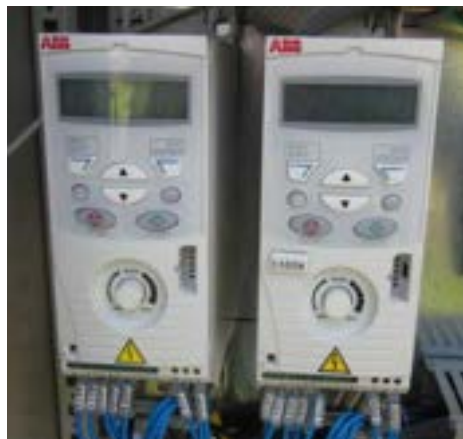
Figura 48 Inverter ventilatori mandata e ripresa.
