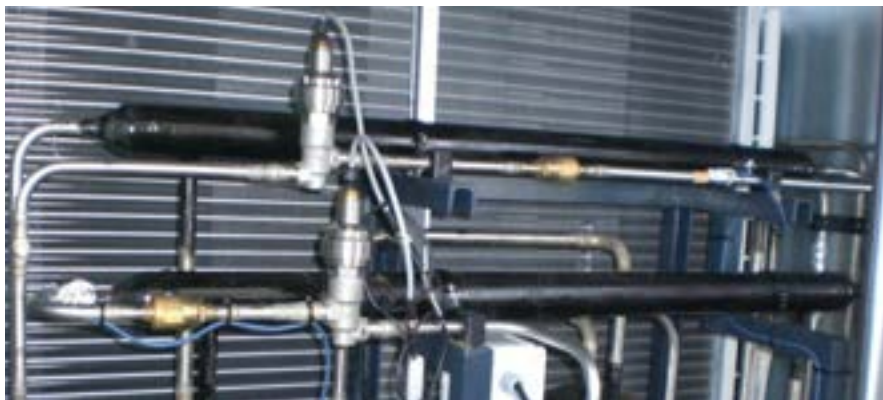
Figura 41 Rigeneratori installati sulla pompa di calore.
