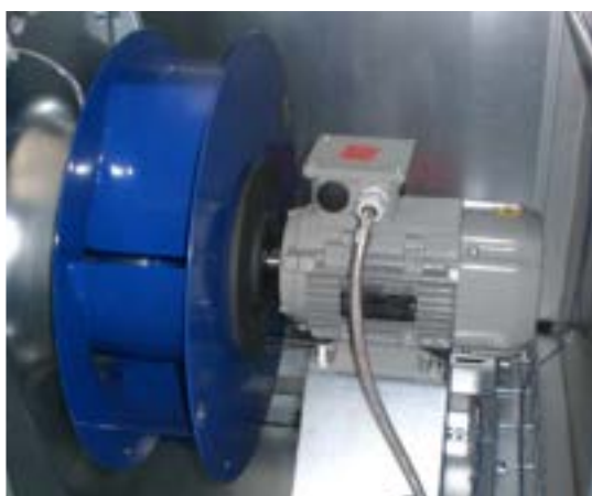
Figura 47 Ventilatore di mandata dell'aria.
