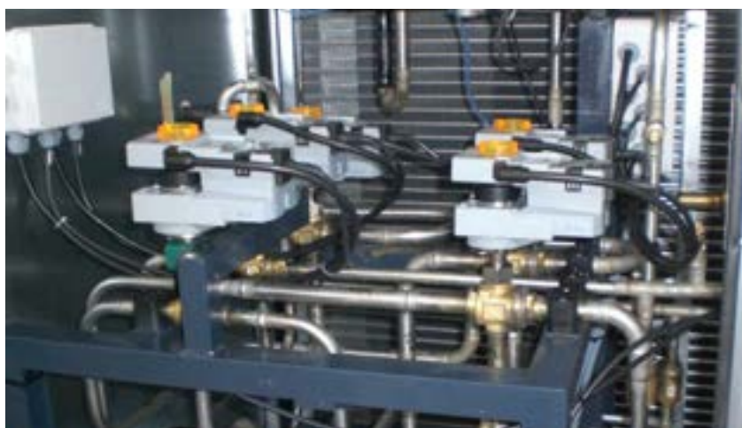
Figura 46 Valvole motorizzate del roof-top.
