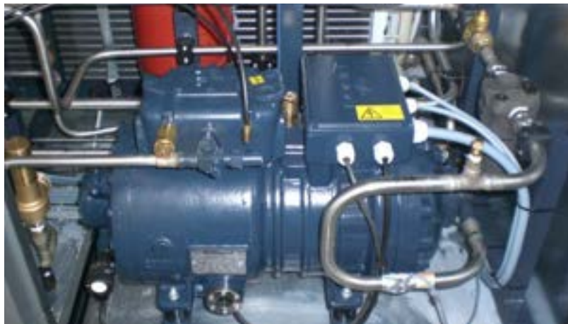
Figura 29 Compressore del roof-top.
