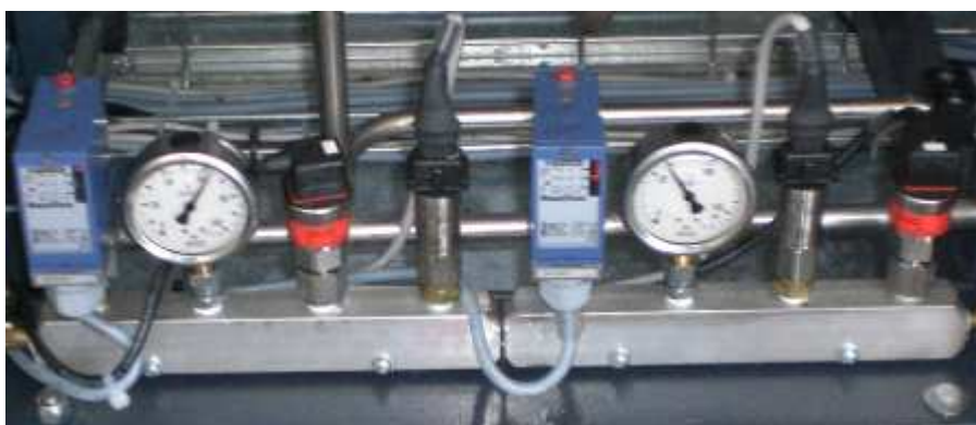
Figura 63 Strumentazione lato CO 2 a bordo roof-top.
