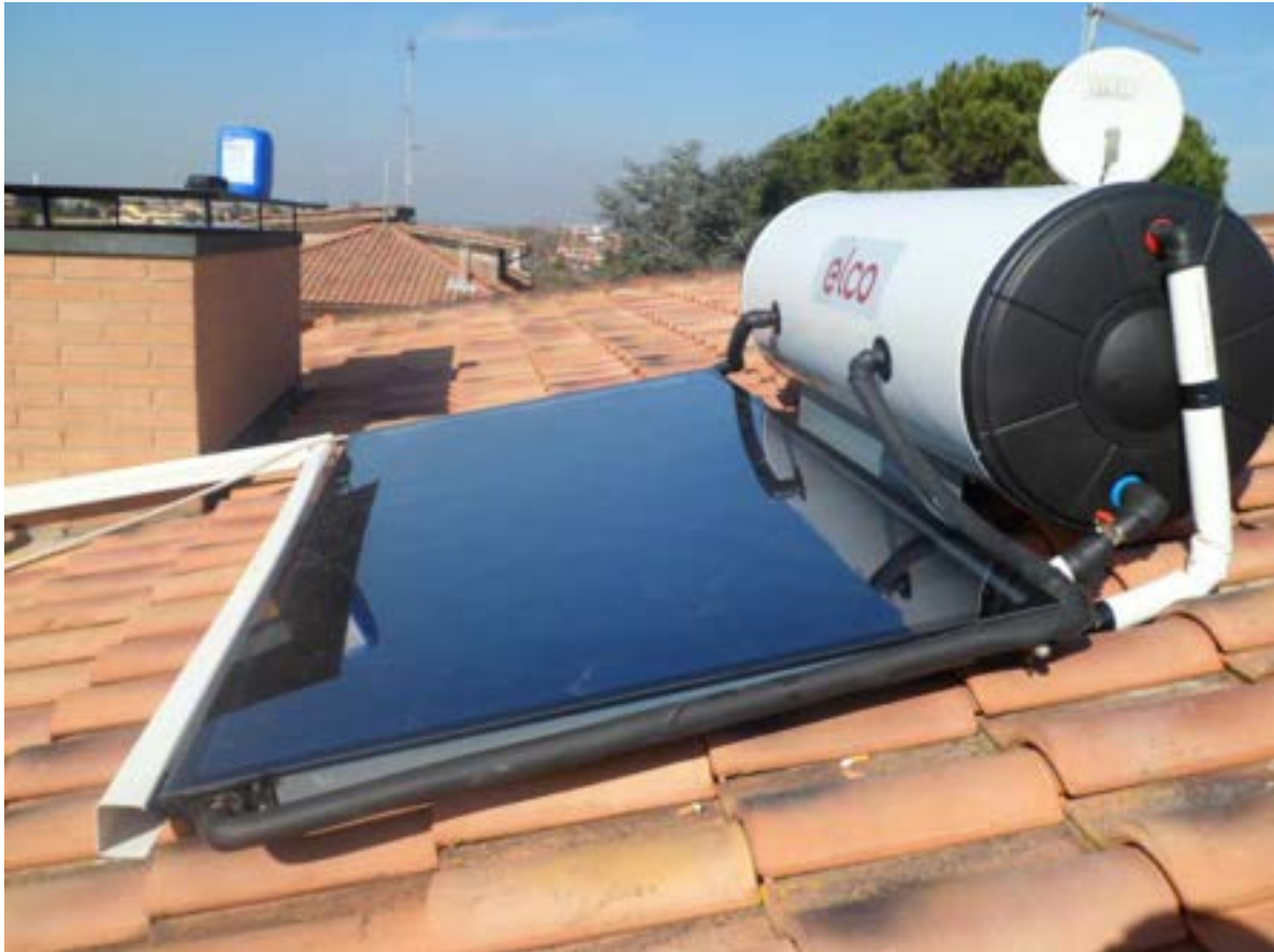
Fig.5 - Sistema solare a circolazione naturale per la produzione di acqua calda sanitaria con collettori solari piani idraulicamente connessi a un bollitore d'accumulo.
