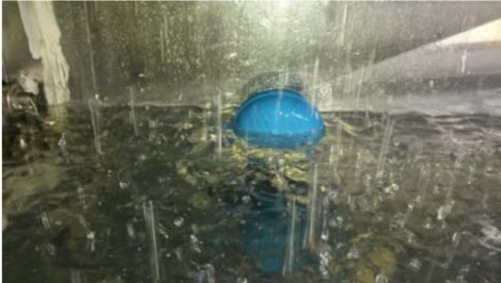
Figura 14. Torre evaporativa in funzione
