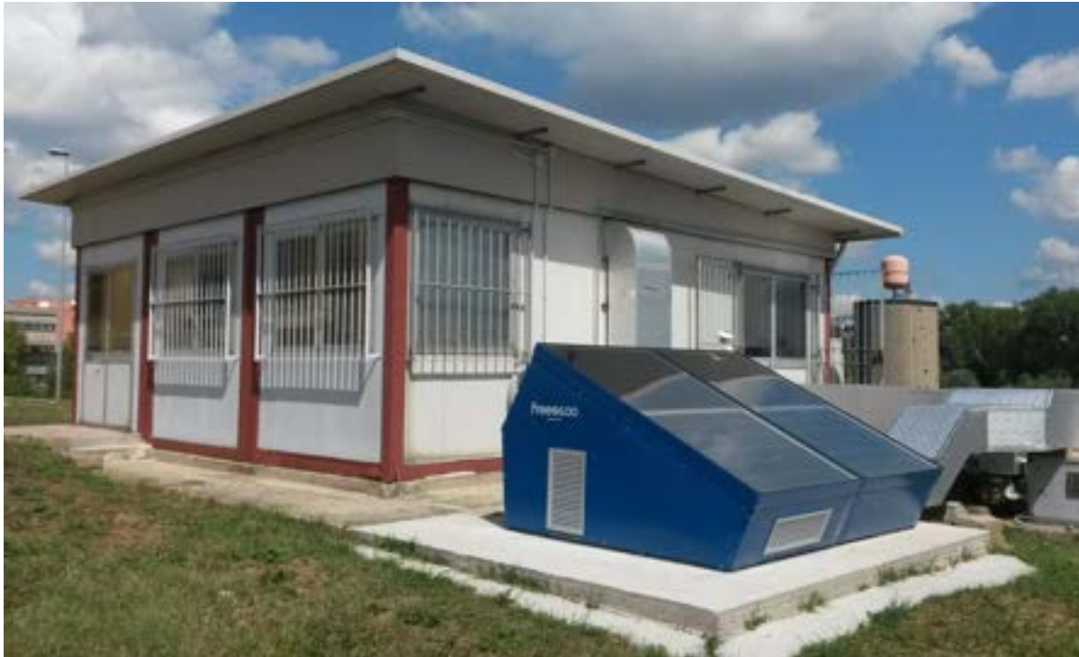
Figura 27. Vista prospettica del locale di prova dell'impianto FREESCOO
