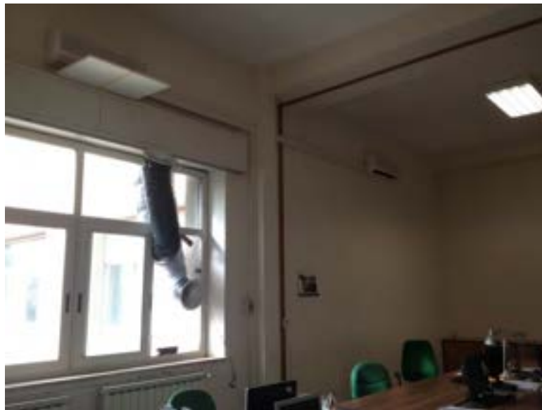
Figura 17: Foto del locale con le tubazioni di collegamento all'unità freesco residential
