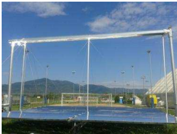
Figura 43: Foto di una seconda installazione su cui sono state eseguite le sperimentazioni in campo (sistema Linear-Fresnel della ditta Glayx Tech)
