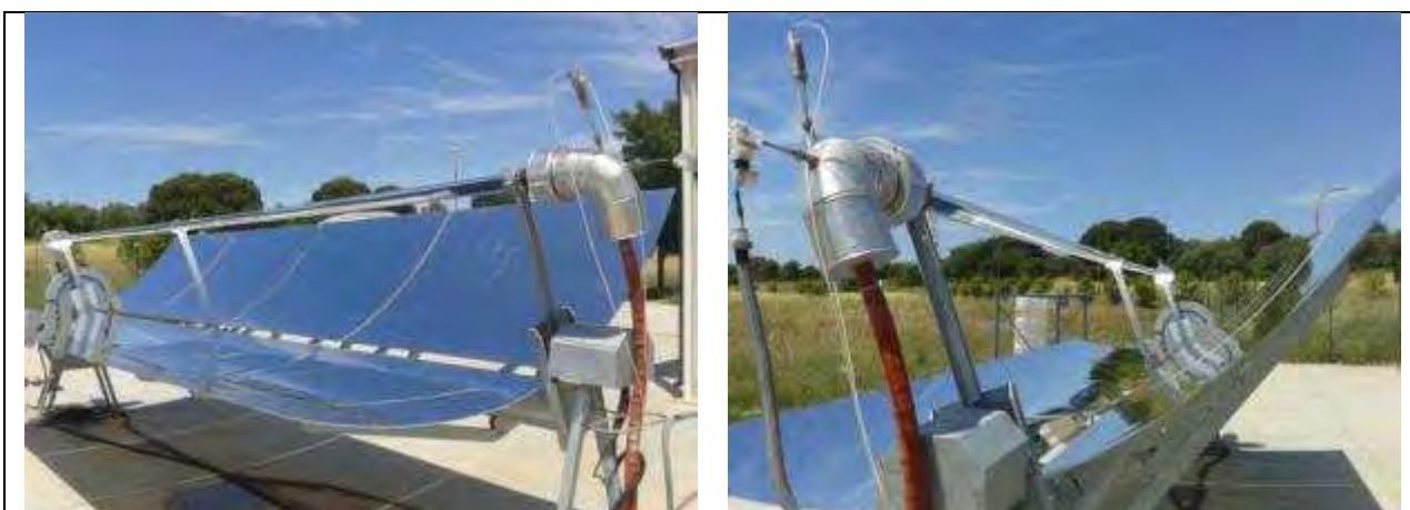
Figura 29: Foto del collettore parabolico lineare in fase di sperimentazione
