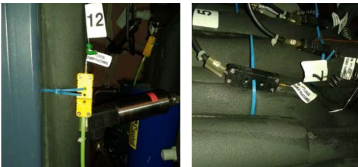
Figura 20. Termocoppie di tipo K (a sinistra) e Termocoppie tipo J (a destra) installate lato refrigerante
