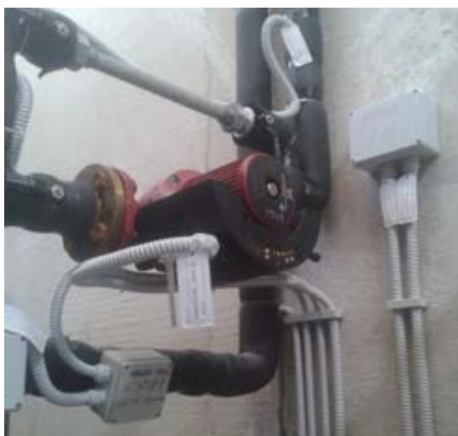
Figura 8. Pompa di circolazione Grundfos
