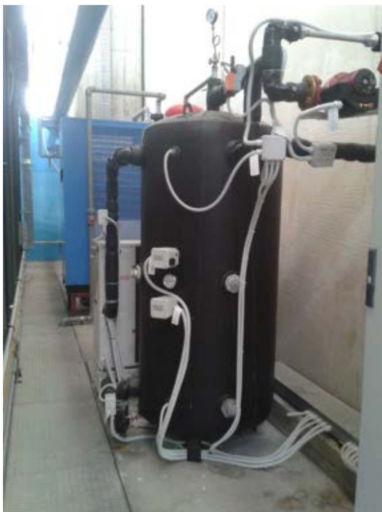
Figura 7. Serbatoio d'accumulo con resistenze elettriche
