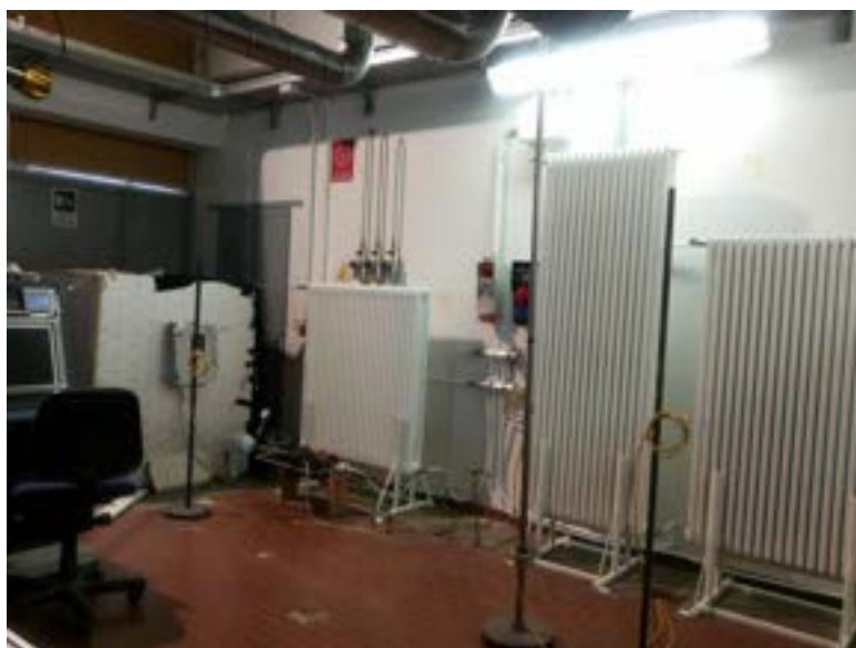
Figura 17. Facility di prova con pompa di calore a CO 2 abbinata a radiatori ad elevato salto termico.
