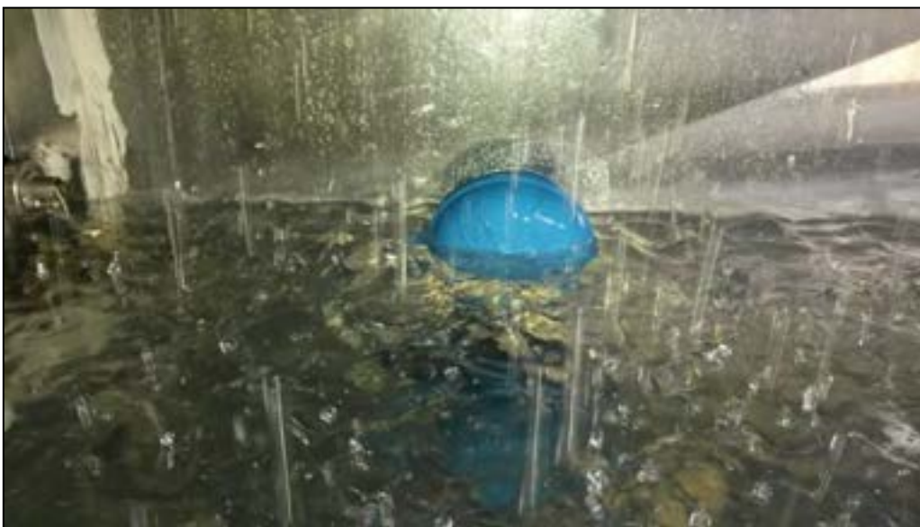
2.2 Torre evaporativa in funzione
