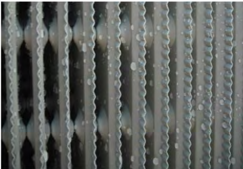
2.7 Particolare dello scambiatore evaporativo a pacco
