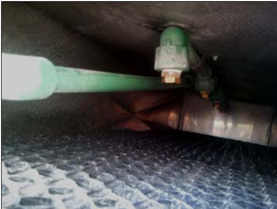
1.5 Ugelli della torre di raffreddamento e condotto del flusso secondario
