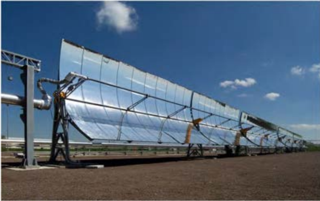
Figura 1 – Impianto solare termodinamico con collettori lineari parabolici (Archimede Solar Plants).
