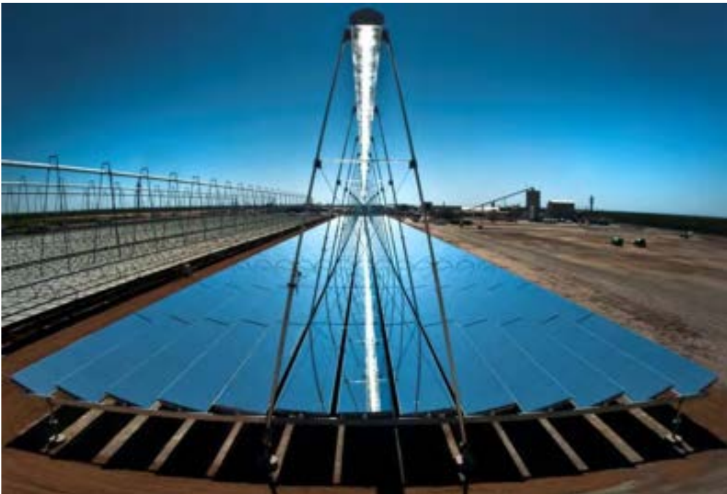
Figura 2 – Impianto solare termodinamico con collettori lineari Fresnel (Areva).
