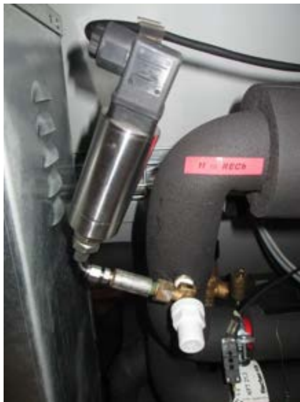
Figura 26. Misuratore di pressione GE Druck PTX montato sulla macchina in prova
