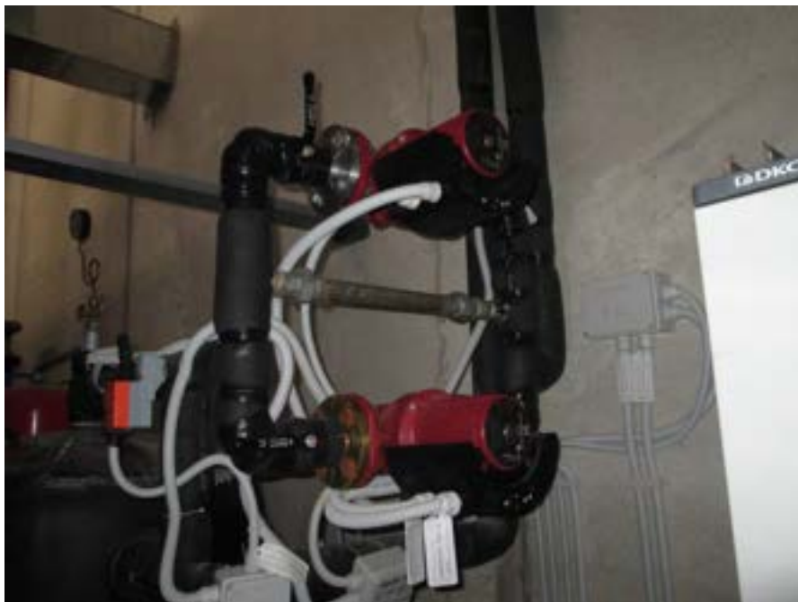
Figura 13. Elettropompe di circolazione Grundfos
