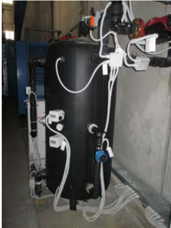
Figura 12. Serbatoio d'accumulo con resistenze elettriche e elettropompa di miscelazione
