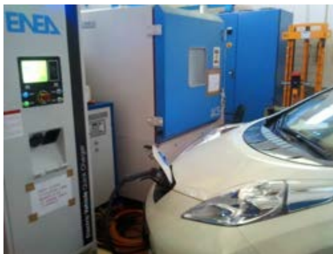
Fig. 1 – Stazione di ricarica rapida EQC-50 Endesa nei Laboratori ENEA –sede Casaccia
