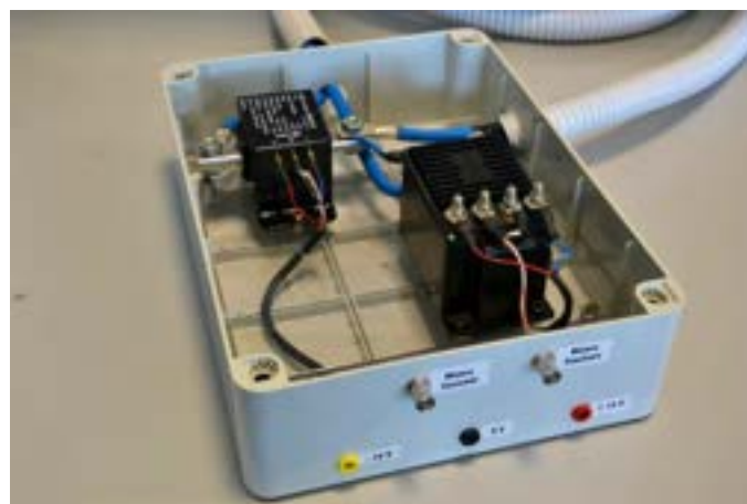
Fig. 18 - Blocco di misura di tensione e corrente lato DC
