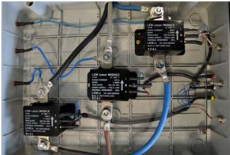
Fig. 17- Vista dall'alto del blocco di misura delle correnti AC trifase
