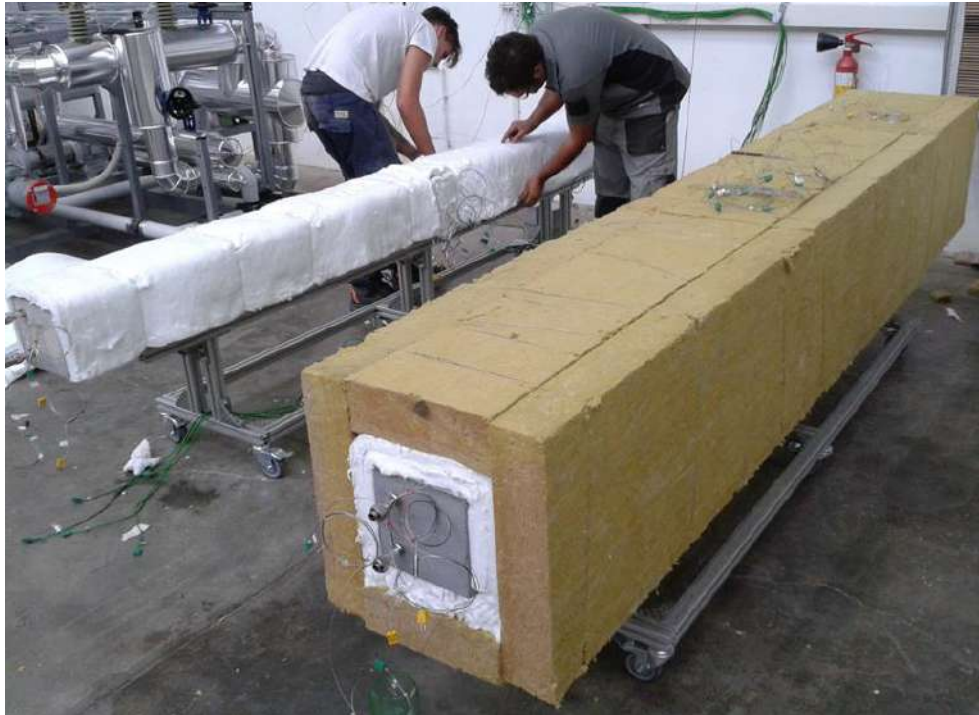
Figura 5: Coibentazione del modulo di accumulo.
