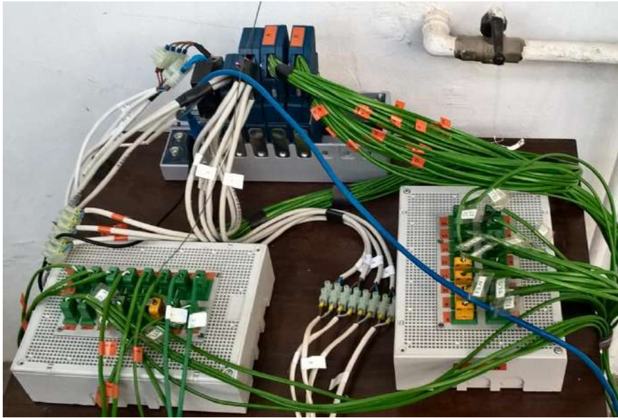
Figura 17: Cablaggio sistema di acquisizione dati
