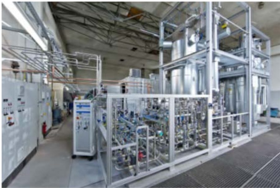
Figura 14. Impianto dimostrativo PtG 250 [66].
