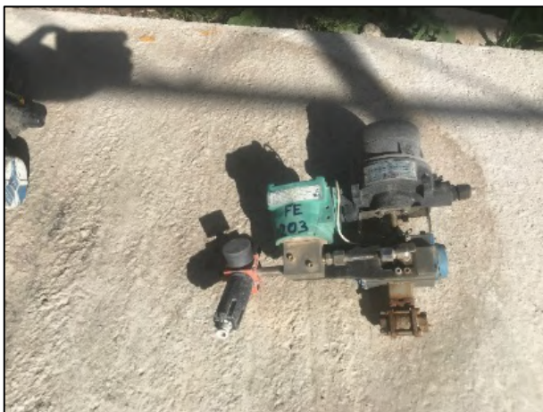
Figura 4.51 - Valvola di intercettazione FE203 della linea azoto al caricamento.
