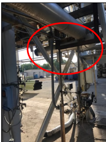
Figura 4.37 – Tubo di alimentazione agenti gassificanti (in alto, all'uscita del riscaldatore).
