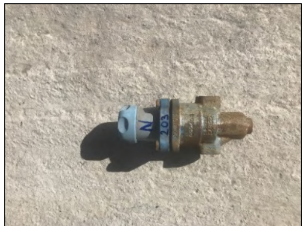
Figura 4.52 - PCV982 sulla linea Azoto al caricamento.
