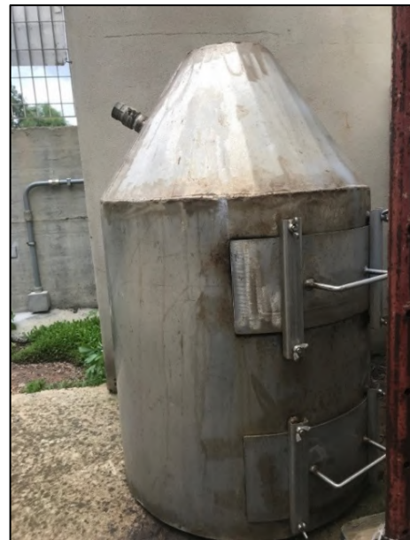
Figura 4.10 - Serbatoio di raccolta ceneri.
