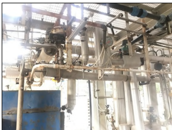
Figura 4.63 - Sistema di tubazioni a monte del BI001
