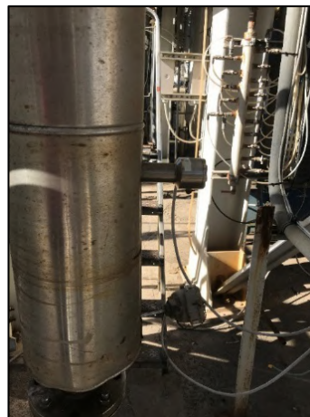
Figura 4.40 – Tubo di alimentazione agenti gassificanti riposizionato verticalmente.
