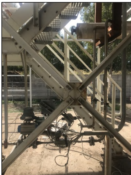
Figura 4.29 – Il sistema di adduzione O 2 e CO 2 prima della rimozione.
