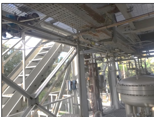
Figura 4.60 - Tubi di collegamento BA003 e reattore.
