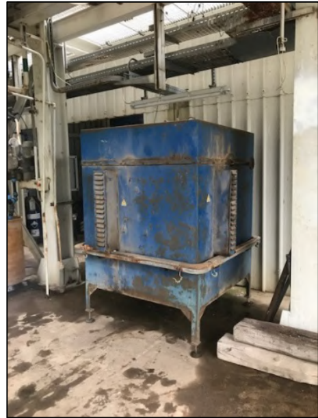
Figura 4.66 - Riscaldatore al termine di disinstallazione e riposizionamento.
