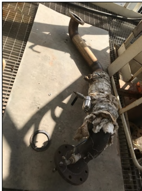
Figura 4.16 - Tubazione di uscita syngas rimossa.
