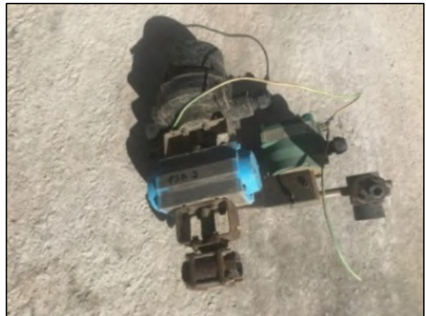
Figura 4.46 – Valvola di intercettazione FU132.
