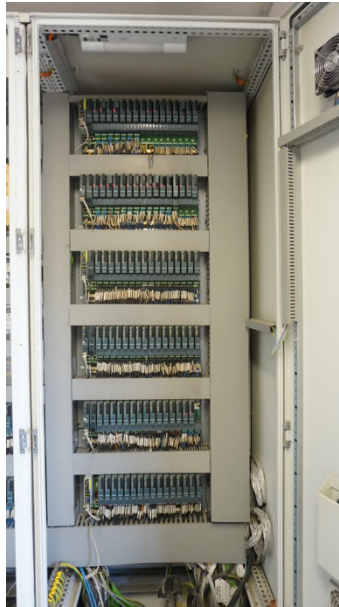
Figura 3.1 – Quadro sistema di controllo.
