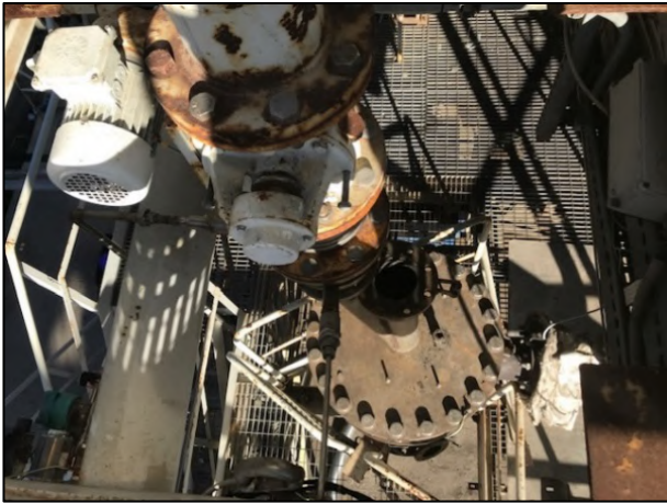
Figura 4.14 - Reattore visto dall'alto, dopo lo scollegamento dalla sezione di caricamento e la rimozione di strumentazione e coibentazione.
