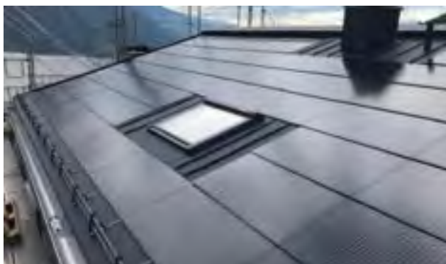
Figura 5. Esempio di impianto BIPV integrato su copertura inclinata [Fonte: SUNAGE].
