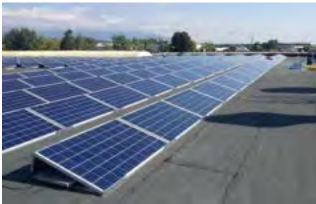
Figura 2. Esempio di impianto BAPV non integrato installato su copertura piana [Fonte: ECO-ROOF].
