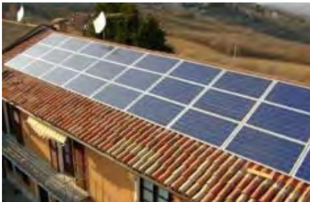
Figura 3. Esempio di impianto BAPV parzialmente integrato installato su copertura inclinata [Fonte: VGS Italia].
