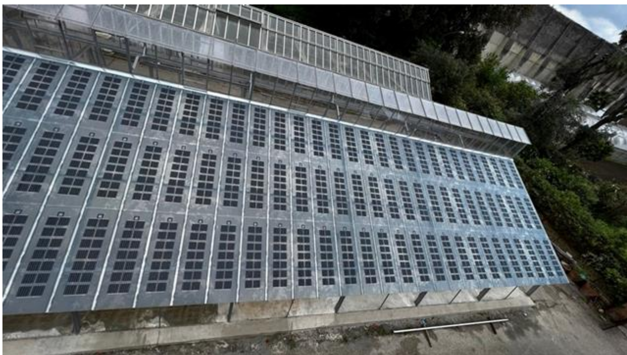
Figura 2.2.8. L'esterno della falda fotovoltaica.
