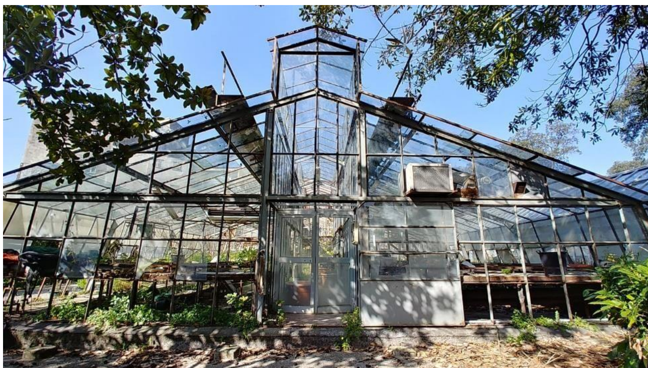
Figura 53, Veduta dell'entrata della serra di "ex-Patologia", si nota lo stato di abbandono della stessa ed il danneggiamento della copertura vetrata in seguito ad eventi metereologici avversi.
