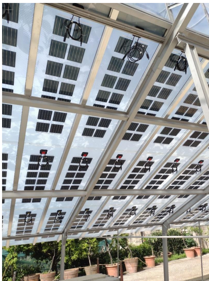
Figura 14 Veduta dal basso dei pannelli BIPV
