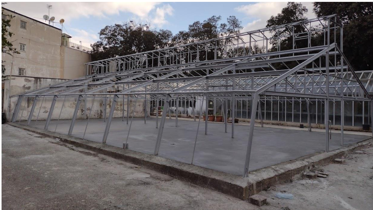
Figura 8 Vista della serra storica dopo la messa a terra del massetto
