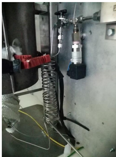
Figura 18. Particolare della serpentina di raffreddamento dei gas in uscita.
