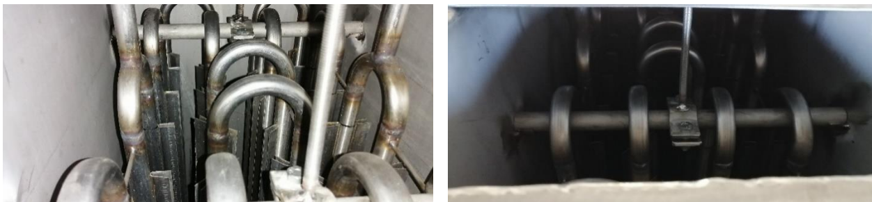
Figura 5- Scambiatore di calore alloggiato all'interno del contenitore.
