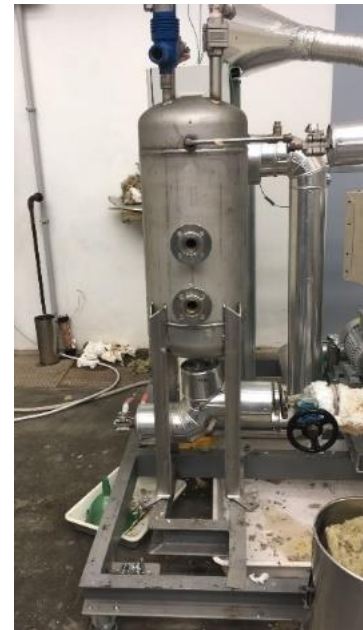
Figura 2-2- Impianto Solteca3 e console di controllo.
