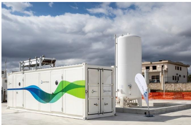
Figura 14 - Metanazione Catalitica: Realizzazione tipica Impianto Demo (fonte: HYSYTECH S.r.l.)
