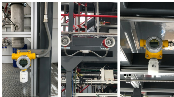
Figura 2.5. Misuratori gas e rilevatori acustici installati nell'impianto.
