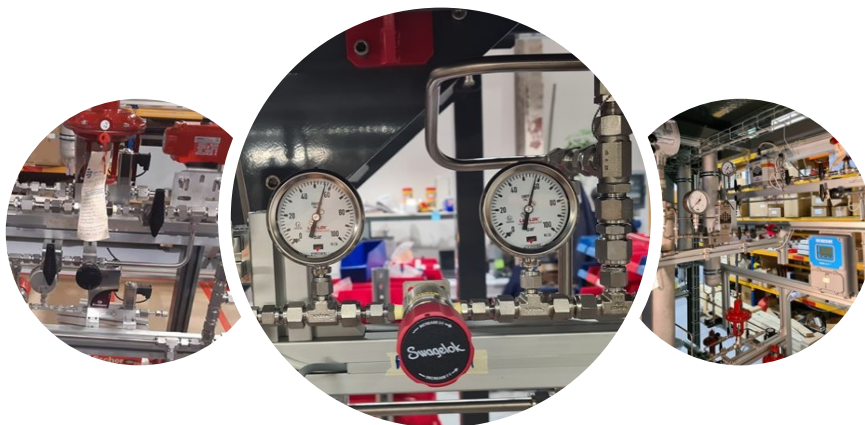
Figura 2.10. Esempio di strumentazione di misura montata sull'impianto.
