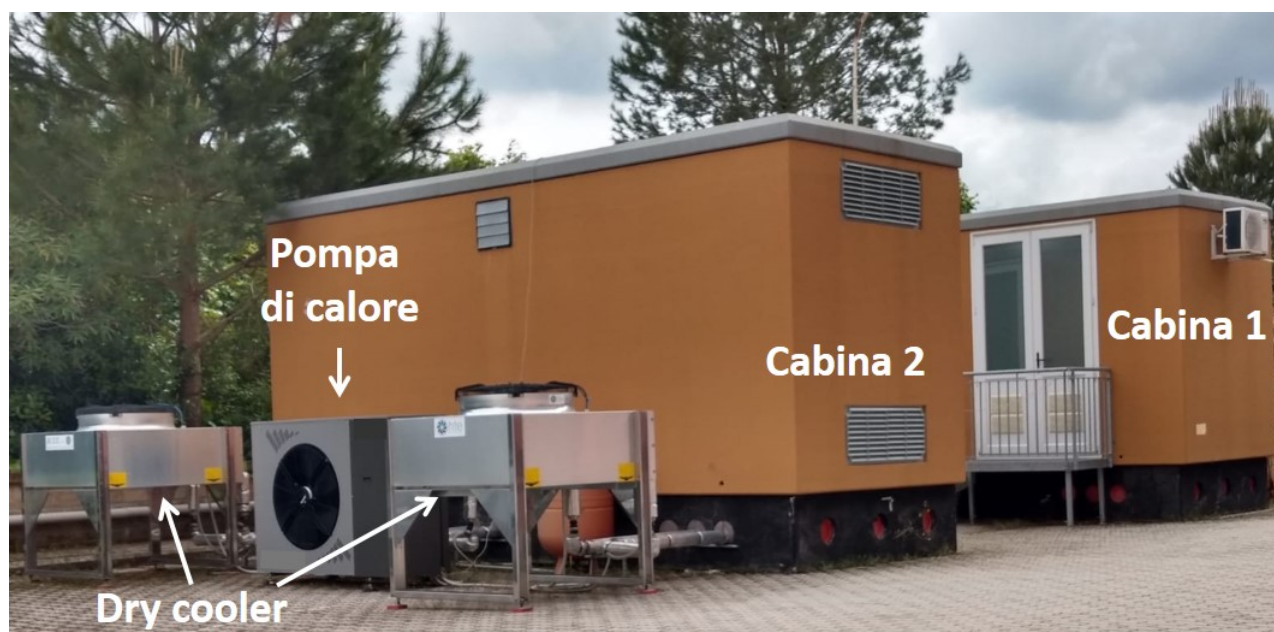
Figura 2: Impianto S.A.P.I.EN.T.E. installato nel C.R. Casaccia
