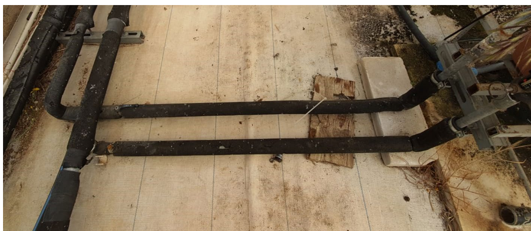
Figura 9: Tubazioni di congiunzione all'interno della serra
