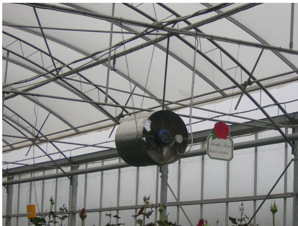
Figura 42. Miselatore d'aria installato all'altezza della linea di gronda in una serra floricola.
