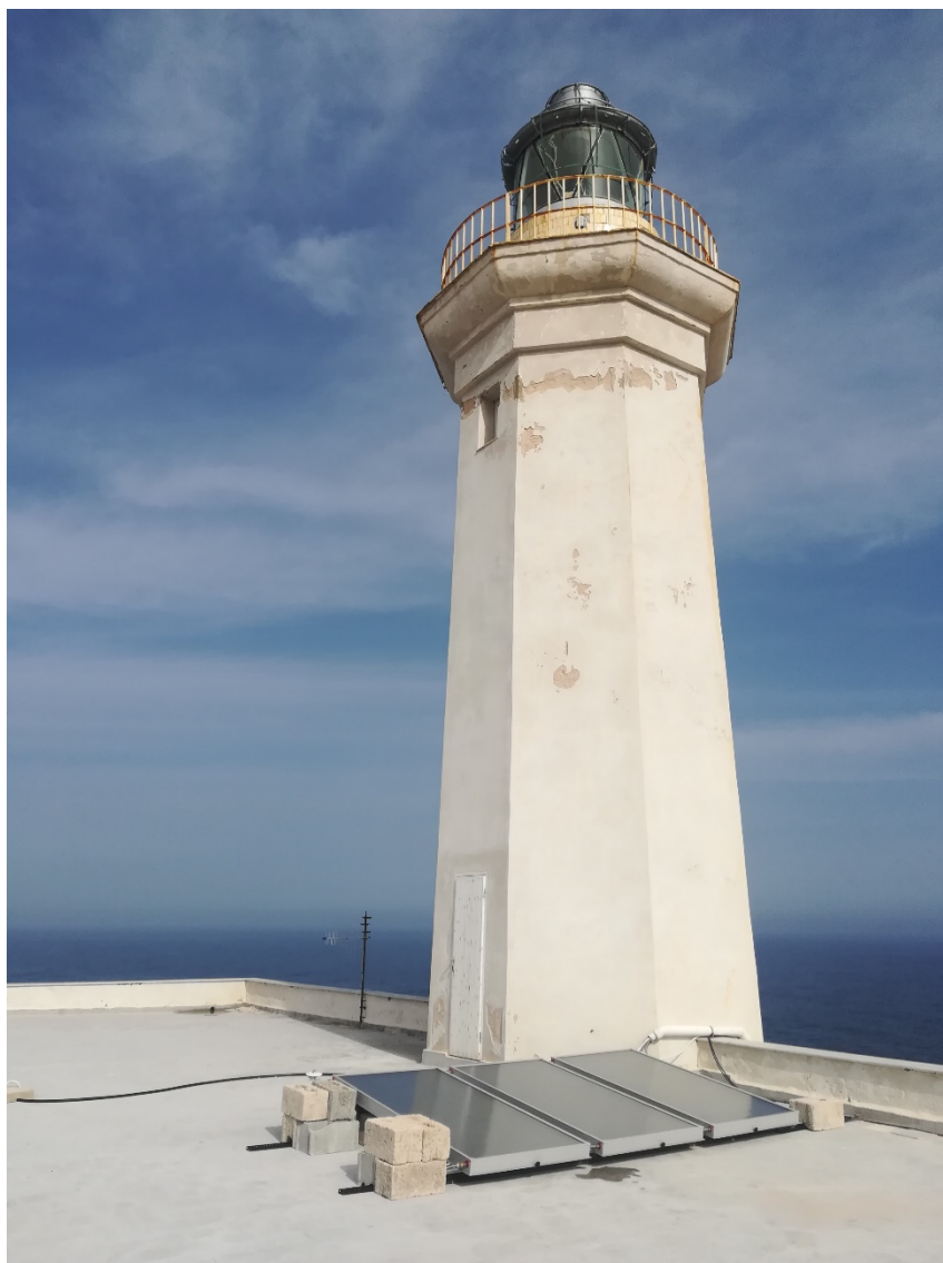
Figura 2.47. Collettori solari dopo il completamento dei lavori
