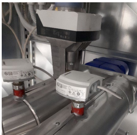
Figura 23. Sensore di temperatura installato sulla sottostazione
