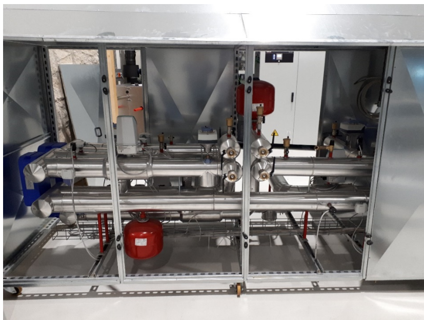
Figura 21. Vista interna della sottostazione
