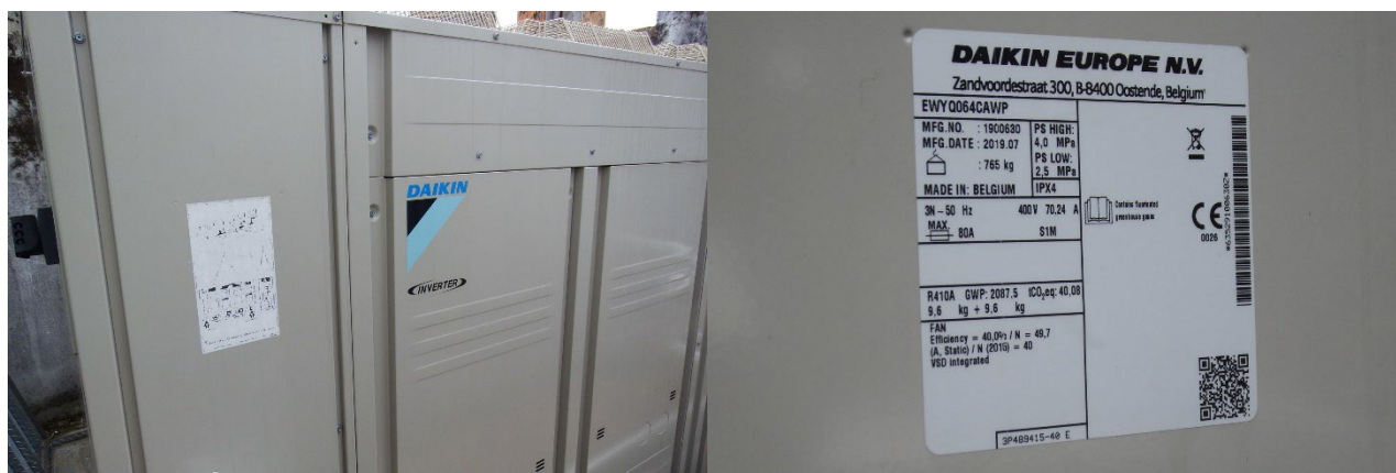
Figura 5-6 Una delle due pompe di calore Daikin EWYQ064CAWP posizionate sulla torretta aperta
