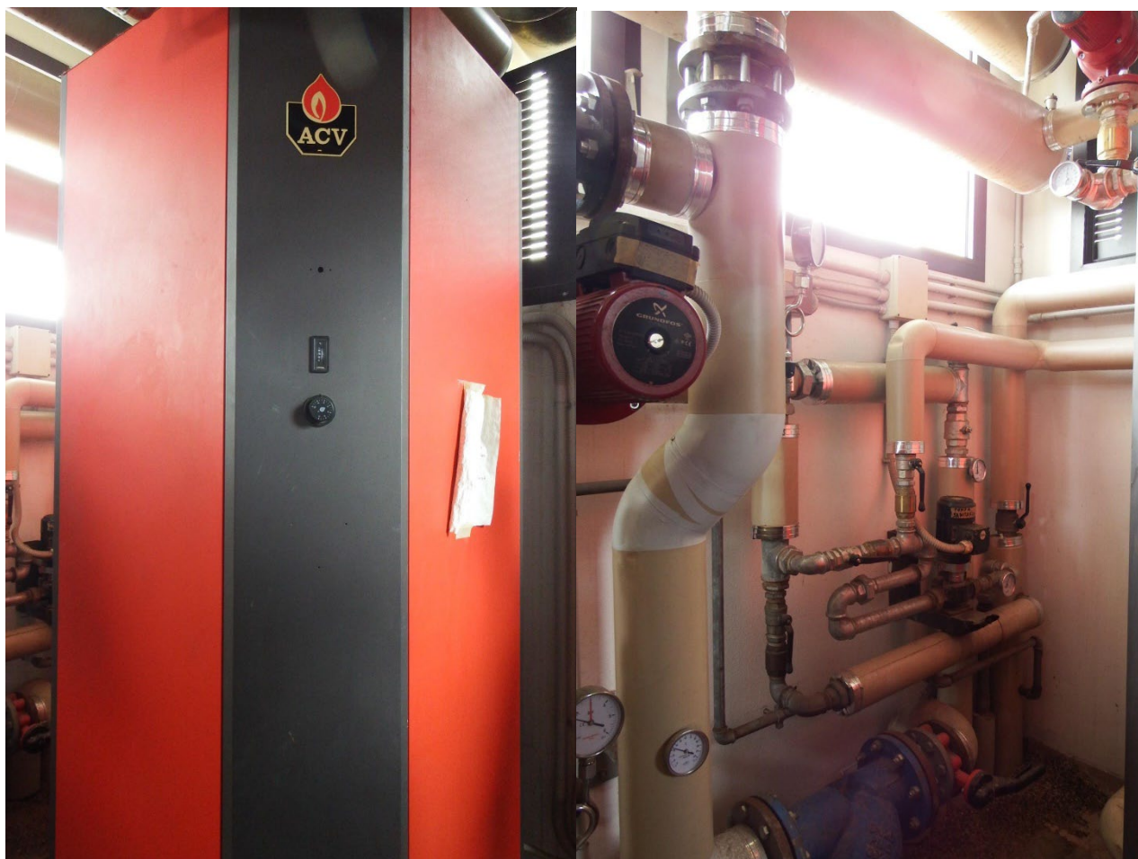
Figura 5-4 A sinistra foto del serbatoio tank in tank ACV, a destra foto del disgiuntore
