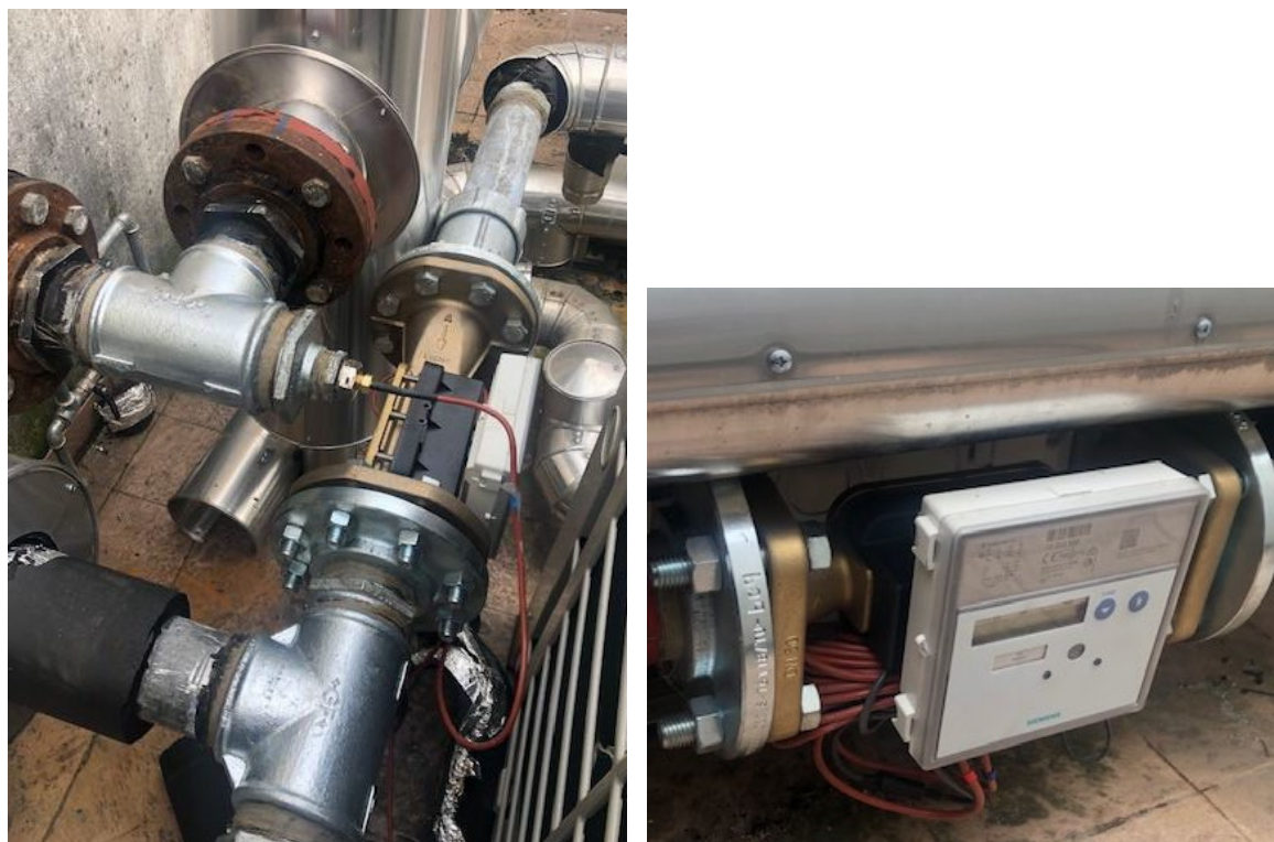
Figura 5-10 Sensori Siemens installati secondo normativa sulle pompe di calore nella torretta aperta di Corte Veronica.
