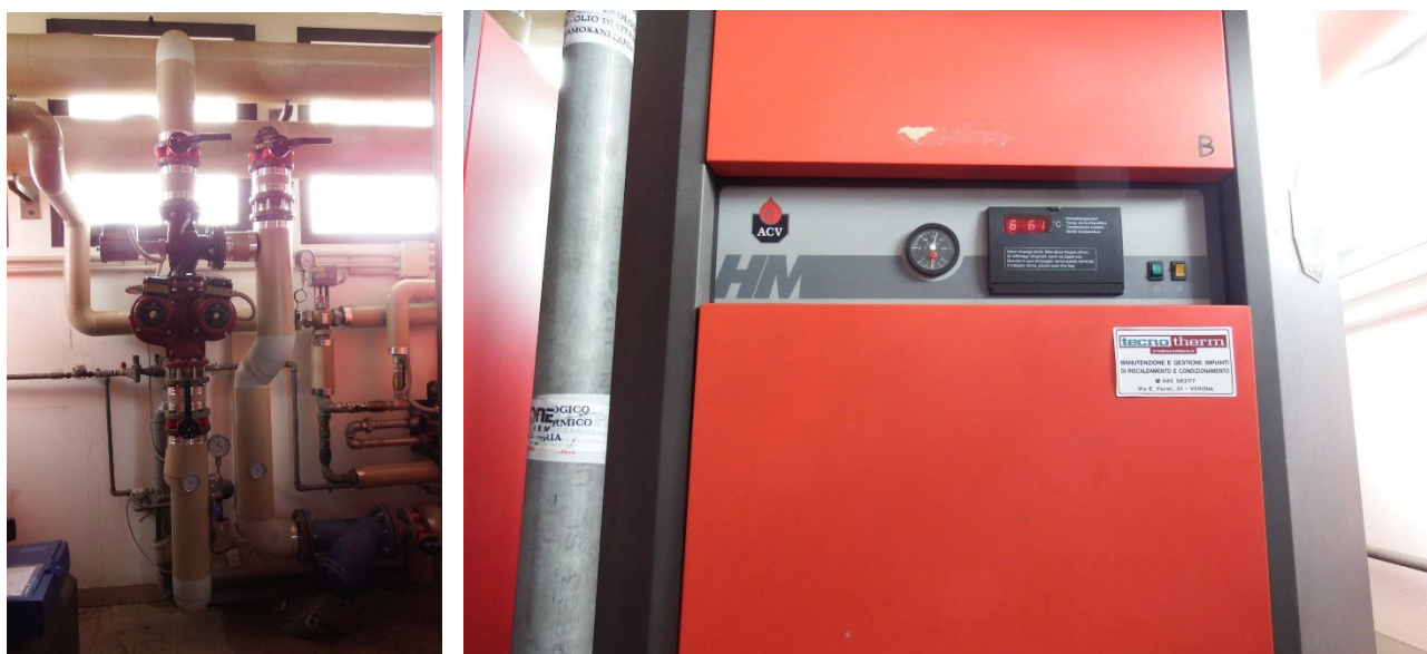
Figura 5-5 A sinistra foto della pompa gemellare Grundfos, a destra foto della caldaia ACV
