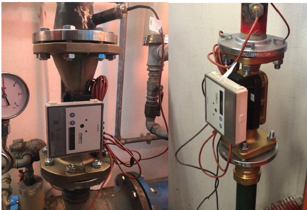
Figura 5-11 Sensori Siemens installati all'interno della centrale termica di Corte Veronica: a sinistra a monte del disgiuntore (T01) e a destra a monte dell'accumulo di acqua calda sanitaria (T02)
