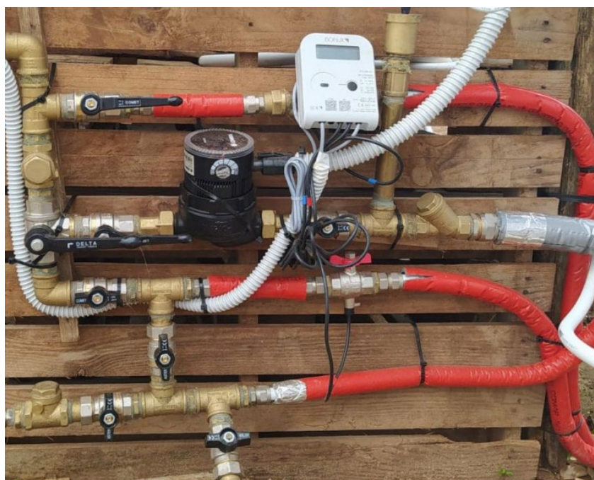
Figura 4-16: Centralina idraulica per la gestione dei flussi di potenza: Dettaglio installazione termoflussimetro circuito piastra termica– dettaglio installazione circolatore nel circuito di mandata pompa di calore – scambiatore acqua fumi
