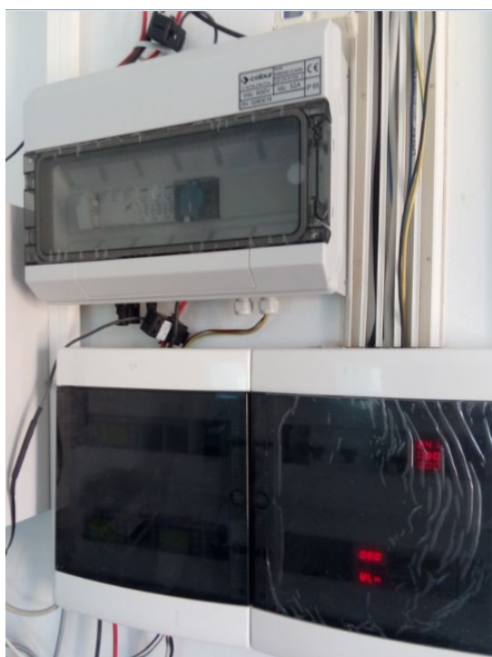
Figura 2-13. Quadri di sezionamento e misura: vista generale
