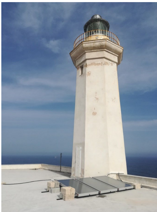
Figura 3-10: Collettori solari dopo il completamento dei lavori
