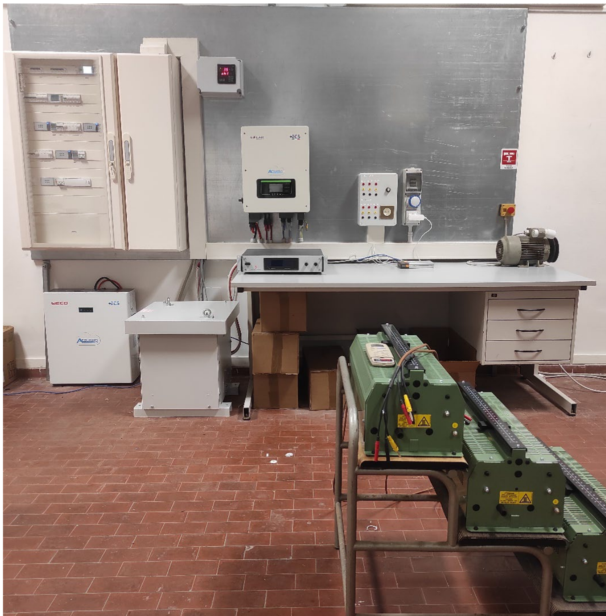
Figura 64. Vista del banco di prova realizzato.
