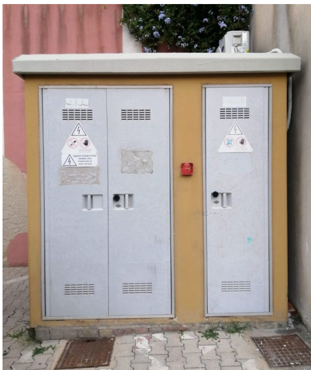
Figura 80. Cabina elettrica n. 131 che alimenta l'area individuata.
