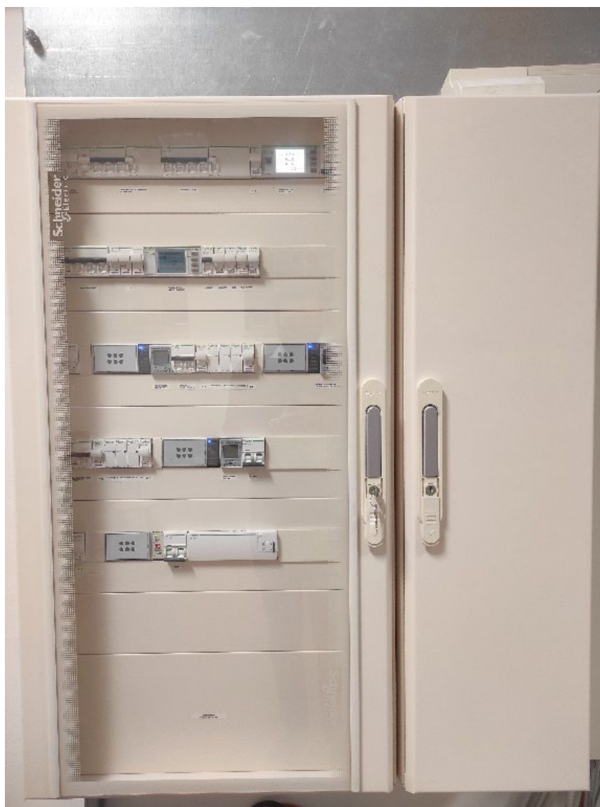
Figura 65. Quadro elettrico di alimentazione, gestione e monitoraggio smart prosumer.
