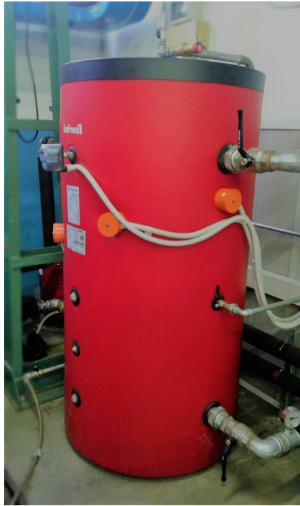
Figura 48 – Fotografia del puffer (riscaldatore elettrico).
