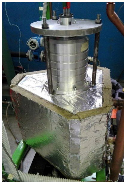
Figura 44 – Foto dell'espansore del sistema ORC installato presso il Laboratorio di Tecnologie di Microgenerazione dell'Alma Mater Studiorum Università di Bologna [10].
