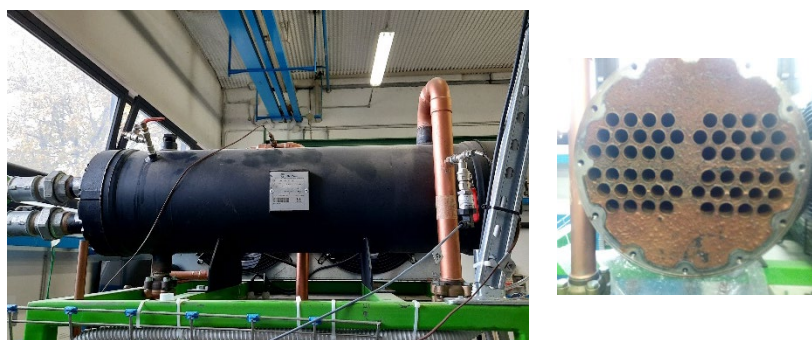
Figura 46 – Fotografie del condensatore a fascio tubiero.
