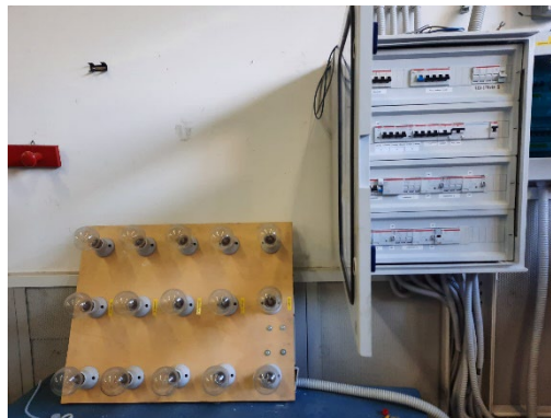
Figura 49 – Fotografia del quadro elettrico e del carico.
