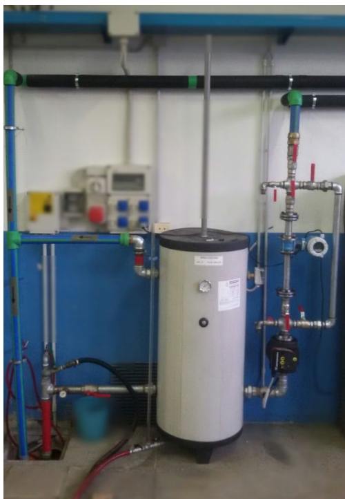
Figura 24 – Foto del serbatoio dell'acqua di raffreddamento installato in Laboratorio e di parte del circuito relativo.
