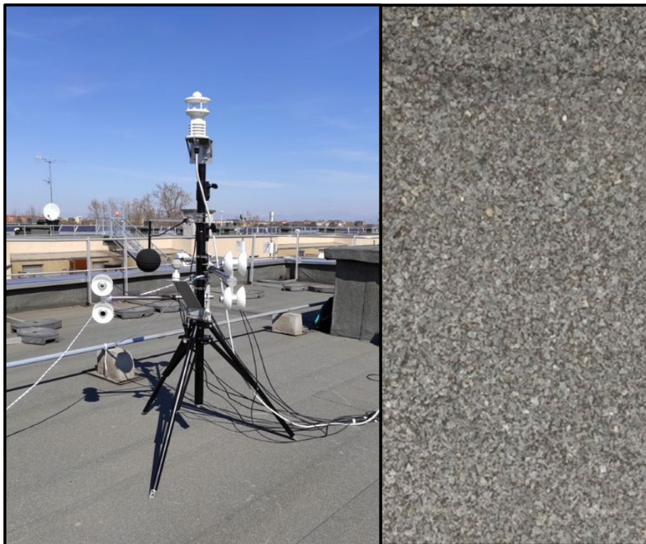
Figura A.23: Dal 23/03/2021 al 26/03/2021, Via Feltrinelli 16, MI: Superficie orizzontale: membrana bituminosa ardesiata.
