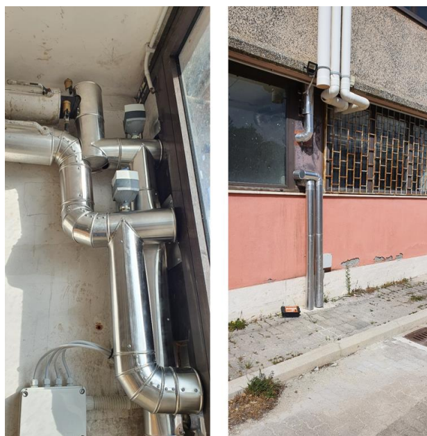
Figura 3: Vista interna ed esterne del locale tecnico e del punto di connessione alla condotta di manda e ritorno della colonna montante con installazione delle due valvole a 3 vie motorizzate
