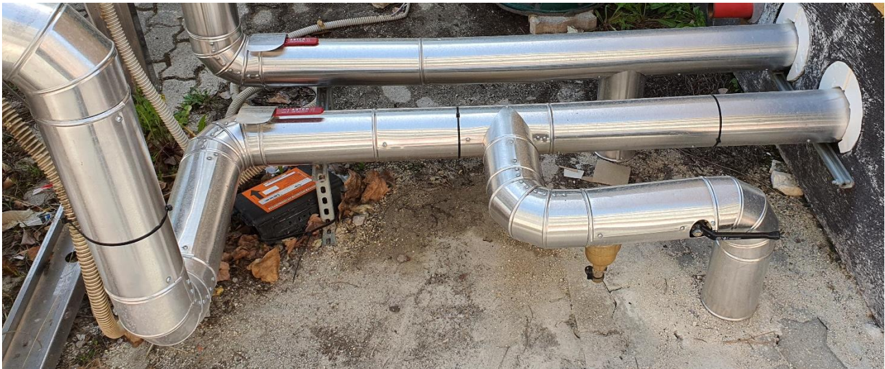
Figura 6: dettaglio Connessione alla tubazione del circuito idraulico drycooler – accumulo caldo/freddo, installazione valvole a tre vie manuali e filtro defangatore
