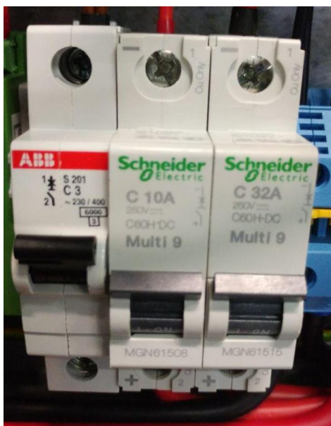
Figura 12 - Interruttori magnetotermici installati nel quadro elettrico
