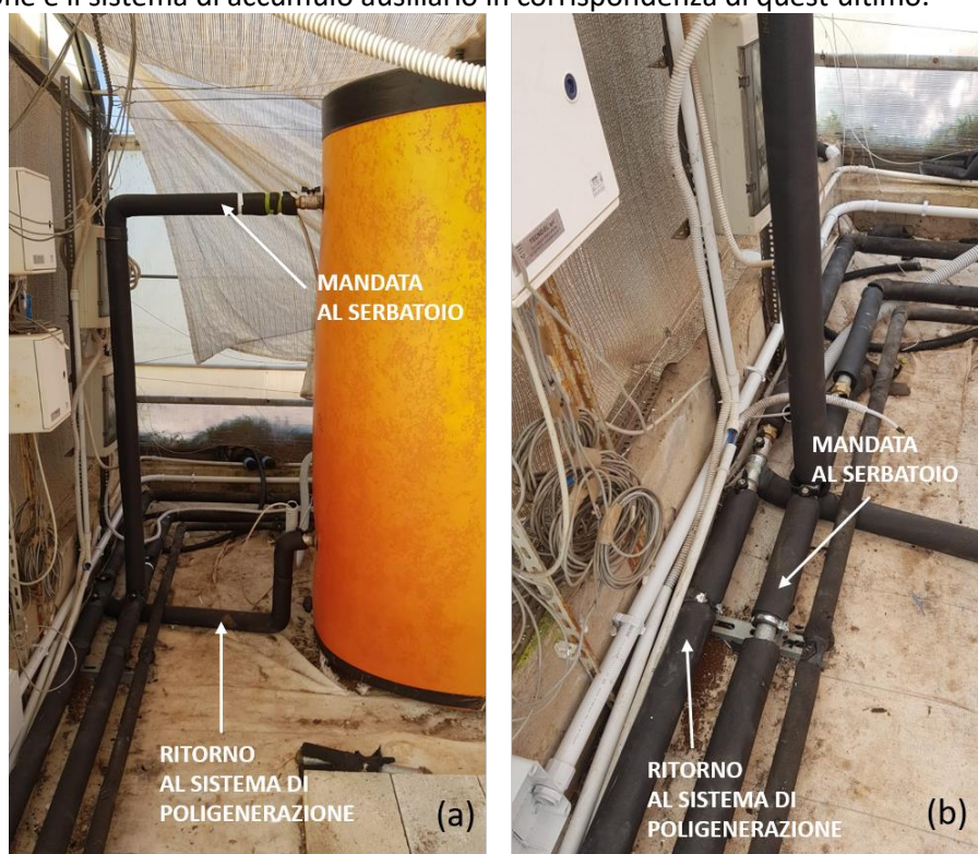
Figura 106. Collegamento tra il sistema di poligenerazione ed il serbatoio di accumulo: vista in corrispondenza del serbatoio (interno alla serra) (a) e dettaglio delle tubazioni di mandata e ritorno (b)
