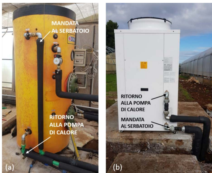
Figura 104. Collegamento tra pompa di calore aria-acqua ed il serbatoio di accumulo: vista in corrispondenza del serbatoio (interno alla serra) (a) e della pompa di calore (b)
