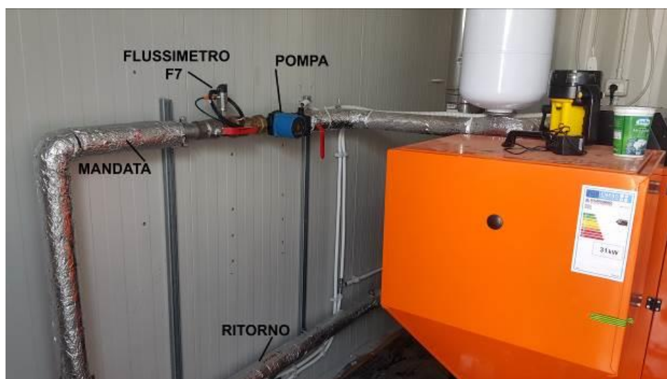
Figura 81. Condotte di mandata dalla caldaia al serbatoio e di ritorno dal serbatoio alla caldaia: vista all'interno del container
