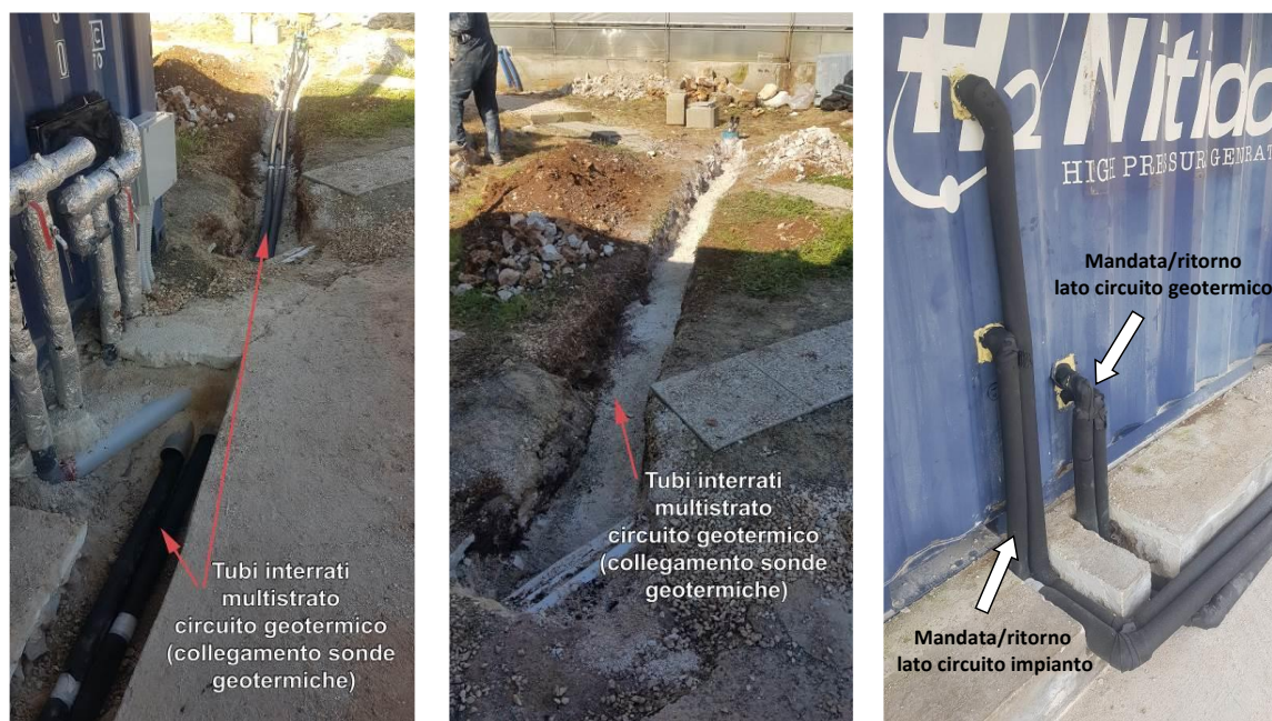
Figura 95. Tubi di mandata alla pompa di calore e ritorno alle sonde (lato circuito geotermico) e tubi di mandata all'utenza e ritorno alla pompa di calore (lato circuito impianto)
