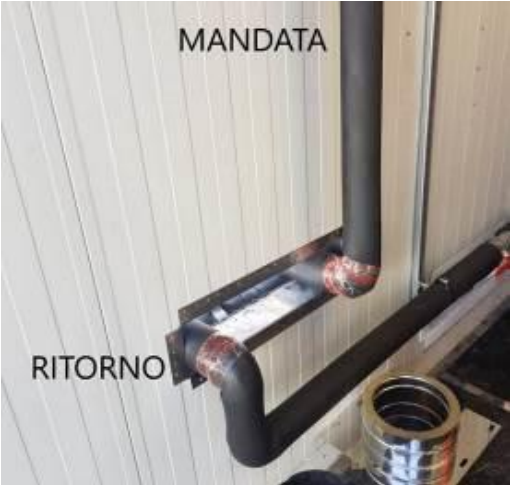
Figura 82. Particolare delle condotte di mandata dalla caldaia al serbatoio e di ritorno dal serbatoio alla caldaia
