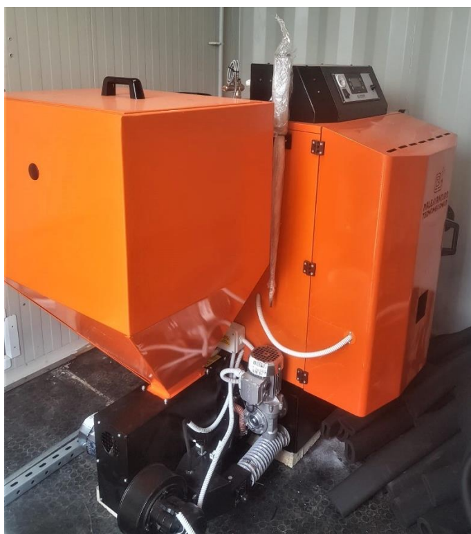
Figura 79. La caldaia a biomassa CS 30 installata all'interno del container
