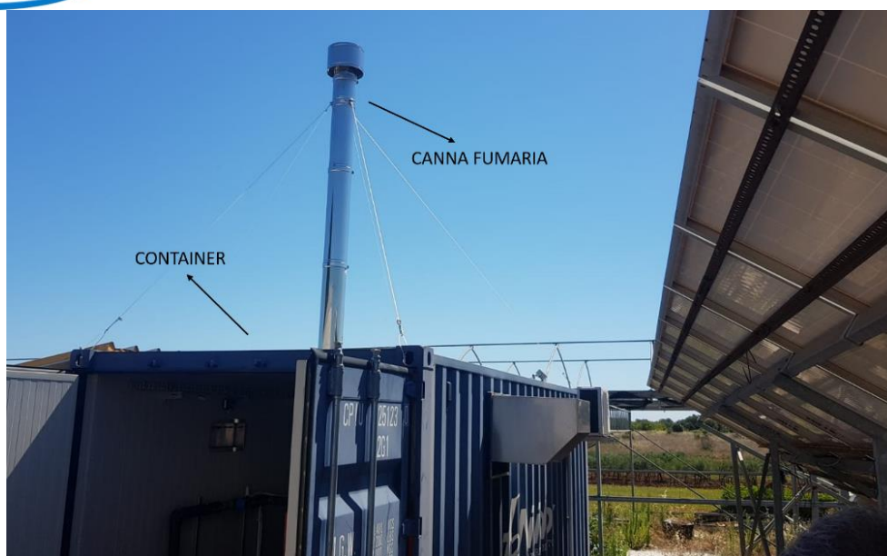
Figura 80. Il container della caldaia a biomassa CS 30
