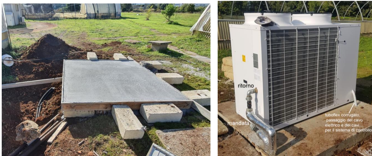
Figura 102. La pompa di calore AERMEC ANLI_HX_HP e il basamento in cemento sul quale è stata ancorata
