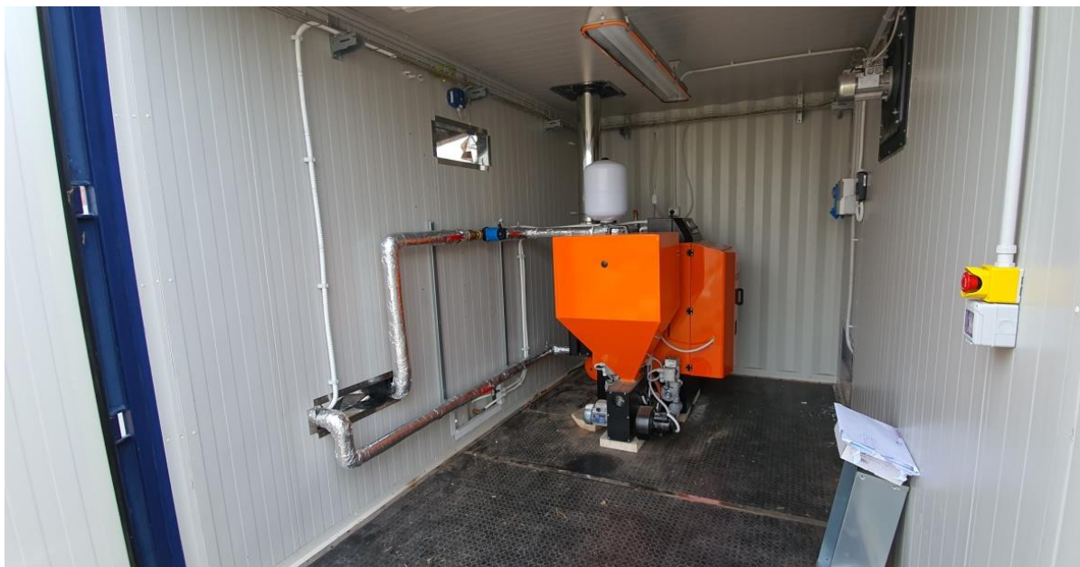
Figura 2. Caldaia a biomassa presso l'Università di Bari.
