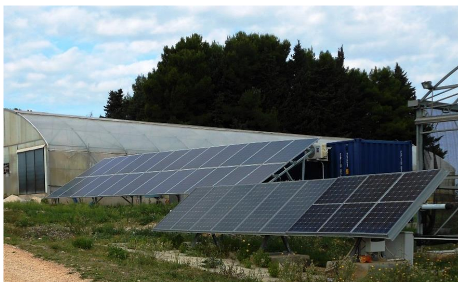
Figura 45. Impianto fotovoltaico presso l'Università di Bari.
