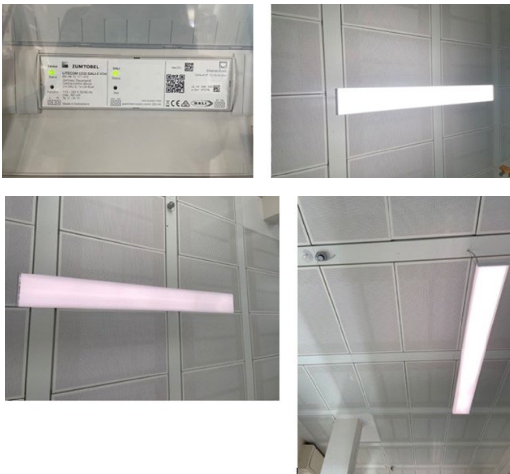
Figura 99. Immagini dei corpi illuminanti installati.
