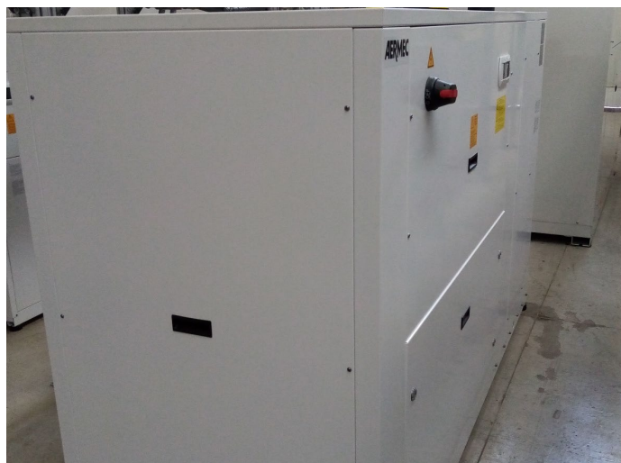
Figura 9. Pompa di calore della rete.
