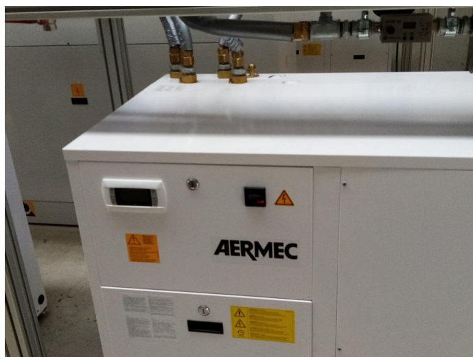
Figura 8. Pompa di calore di ciascun'utenza.
