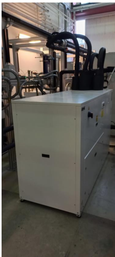
Figura 12. Pompa di calore della rete (AERMEC WRL500).
