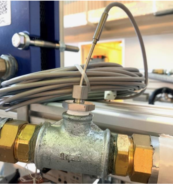
Figura 25. Sensore di temperatura PT100.
