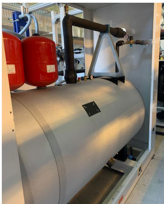
Figura 14. Serbatoio di accumulo da 1000 litri.
