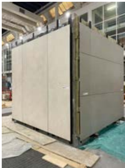
Figura 271. Vista delle pareti ovest (a destra) e nord (a sinistra) del provino finito
