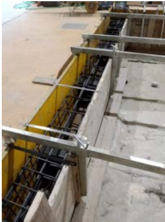
Figura 236. Realizzazione della trave di fondazione: vista dei ferri longitudinali e delle staffe
