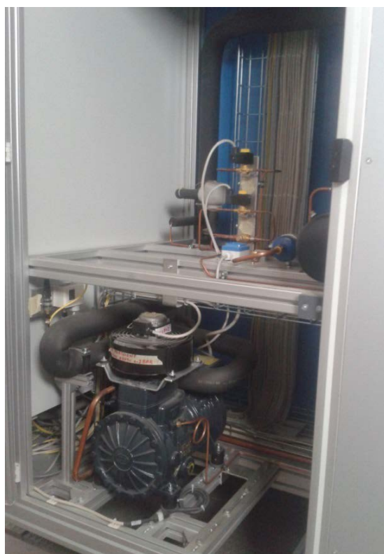
Figura 2 - Gruppo Frigorifero da 21 kW pre-intervento di potenziamento
