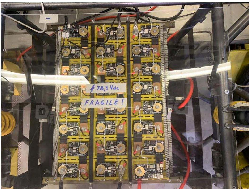
Figura 15 - Pacco batterie del veicolo elettrico URBE
