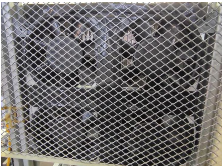
Figura 27. Ventole di raffreddamento del condensatore
